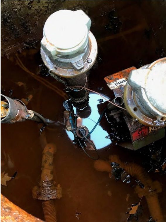
Wasser im Zugang zum Lagertank (Domschacht)
